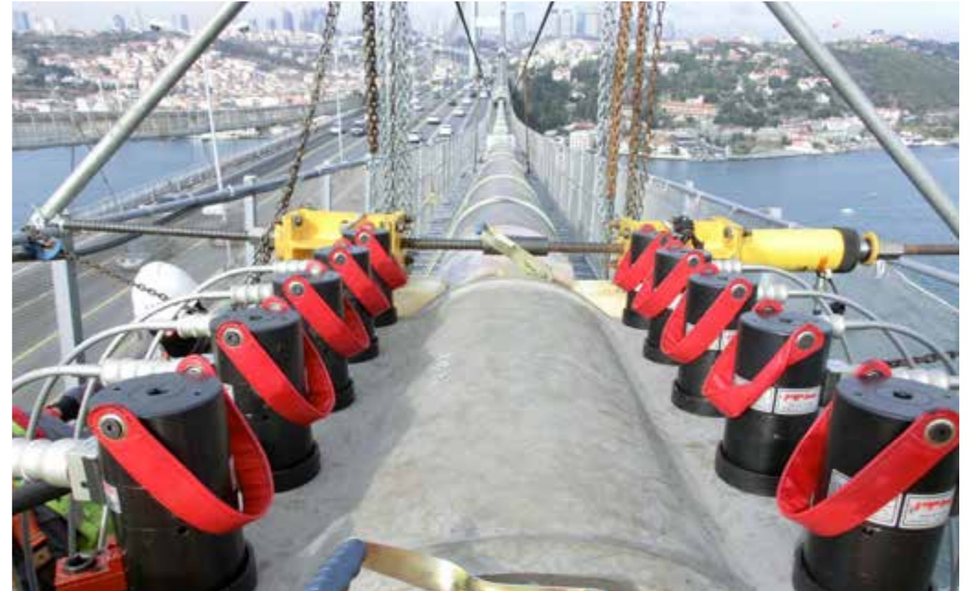
Hoch über dem Bosphorus wird die Autobahnbrücke durch Schraubenverbindungen von ITH aus Meschede gehalten: Ein Weltmarktführer aus Südwestfalen.
